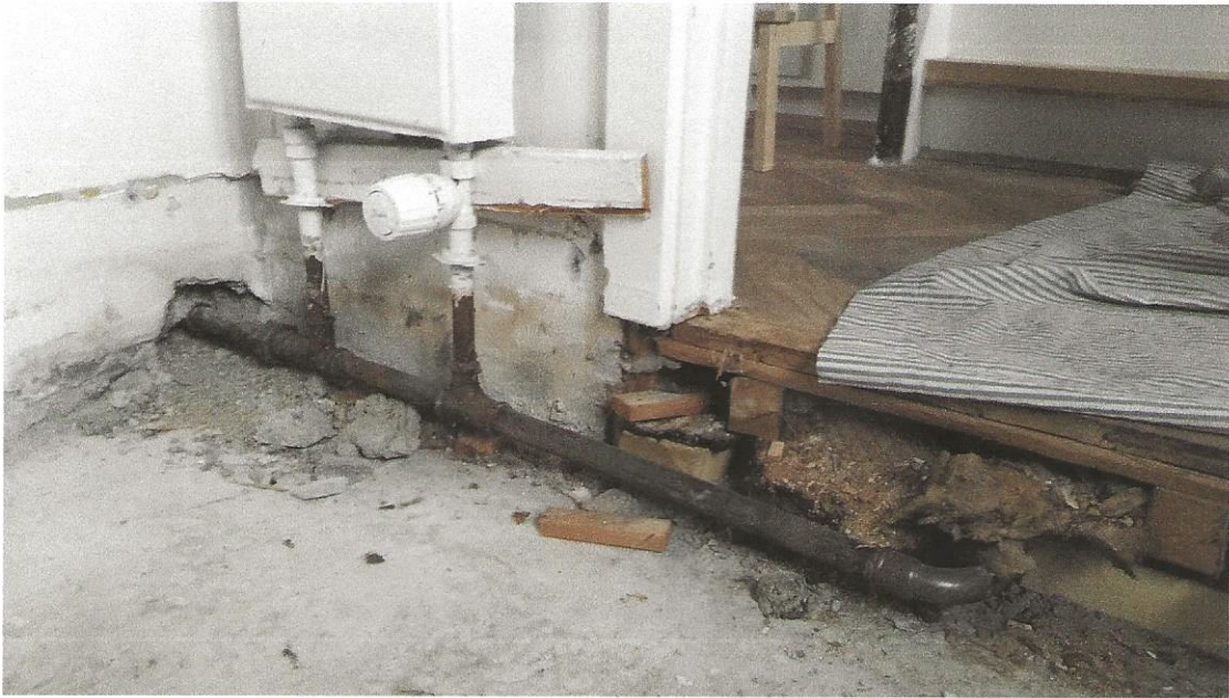
Centralvarmerør til radiator i køkken.
