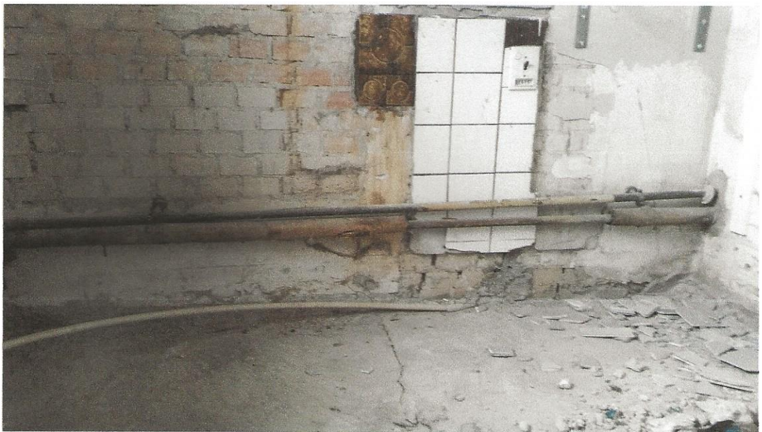
Rør til varmt og koldt brugsvand fra køkken og ind på badeværelse.
